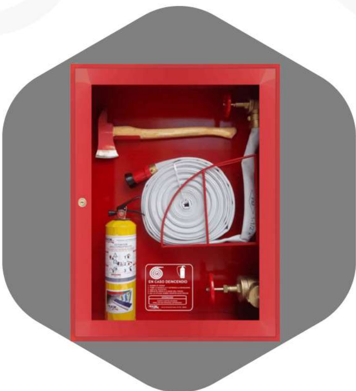
GABINETE CONTRA INCENDIOS Y ACCESORIOS
